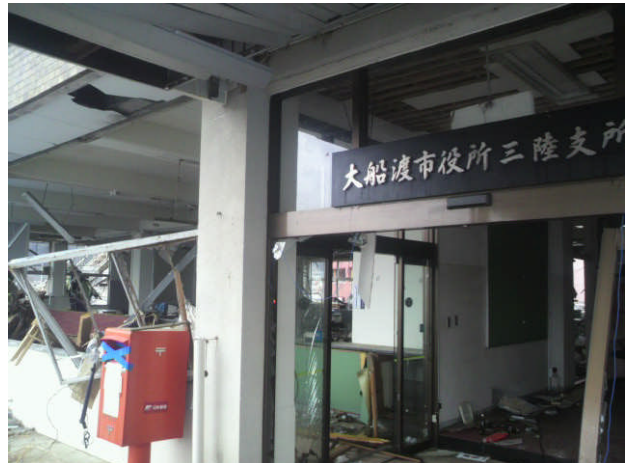
2階まで津波を被った大船渡市三陸支所
